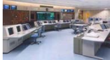
DCS（監視制御設備）
